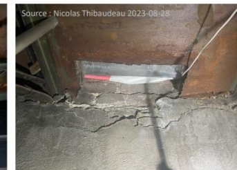
Figure 8.6 – Mur de fondation friable au sommet
