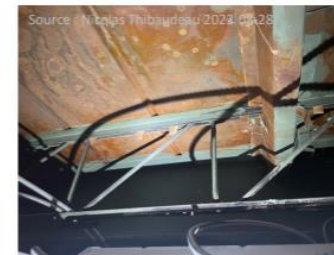
Figure 8.4 – Pontage métallique corrodé
