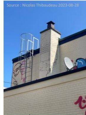
Figure 8.1 – Cheminée fissurée à l'arrière
