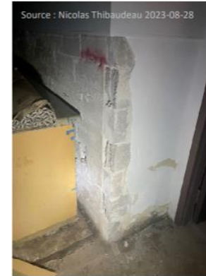
Figure 8.2 – Cloison en bloc de béton friable
